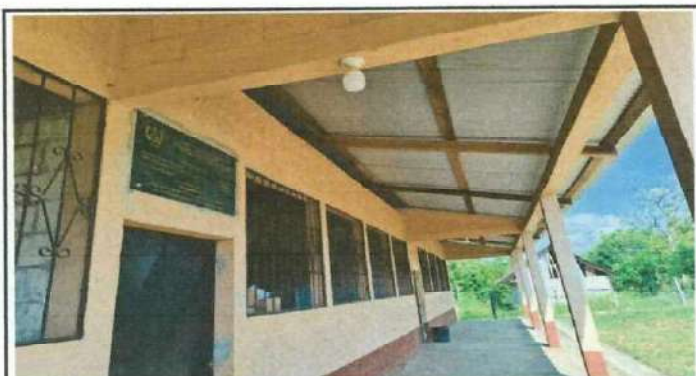
Foto 3: ESTRUCTURA Y CUBIERTA DE LAMINA DENTRO DE LAS AULAS, REQUIEREN SUSTITUCION
